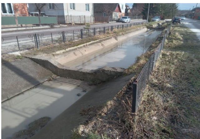
Рис. 2. Канал дощового водовідведення по вулиці Зеленій міста Миколаїв.
